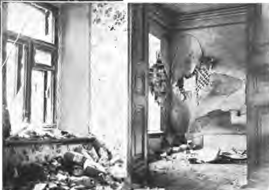
Кровавые дни въ Москвѣ. Въ квартирѣ Шугаева. Поврежденія, причиненныя разорвавшимся снарядомъ. По фот. Смирнова.
