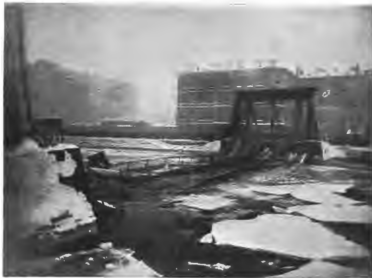
Проваль Египетскаго моста (черезъ р. Фонтанку) въ Петербургѣ, 20-го января с. г. Общій видъ моста послѣ провала.
