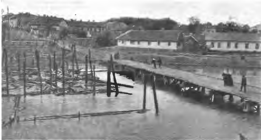
Мостъ, разрушенный австрійцами, и наведенный нами временный мостъ.
